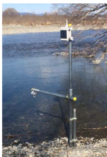
写真 1.3 超音波水位計測
