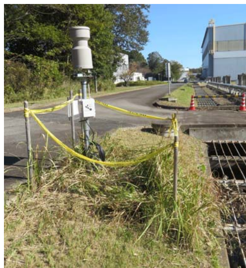
写真5 LoRa観測ノード雨量・水位
